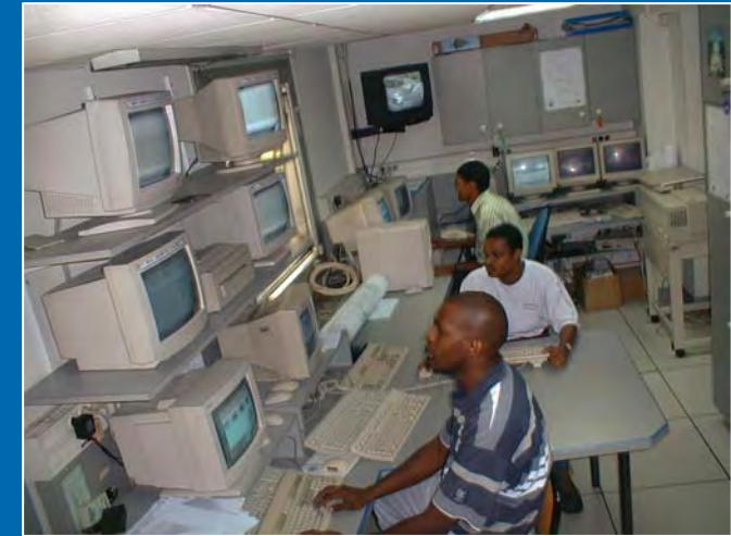
Salle de gestion technique centralisée
