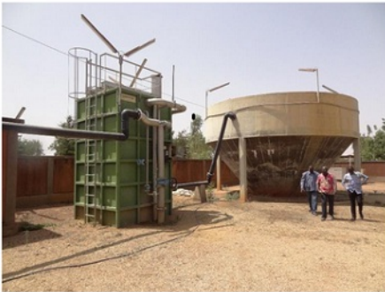
Planta de tratamiento actual de ONEA en Boromo
